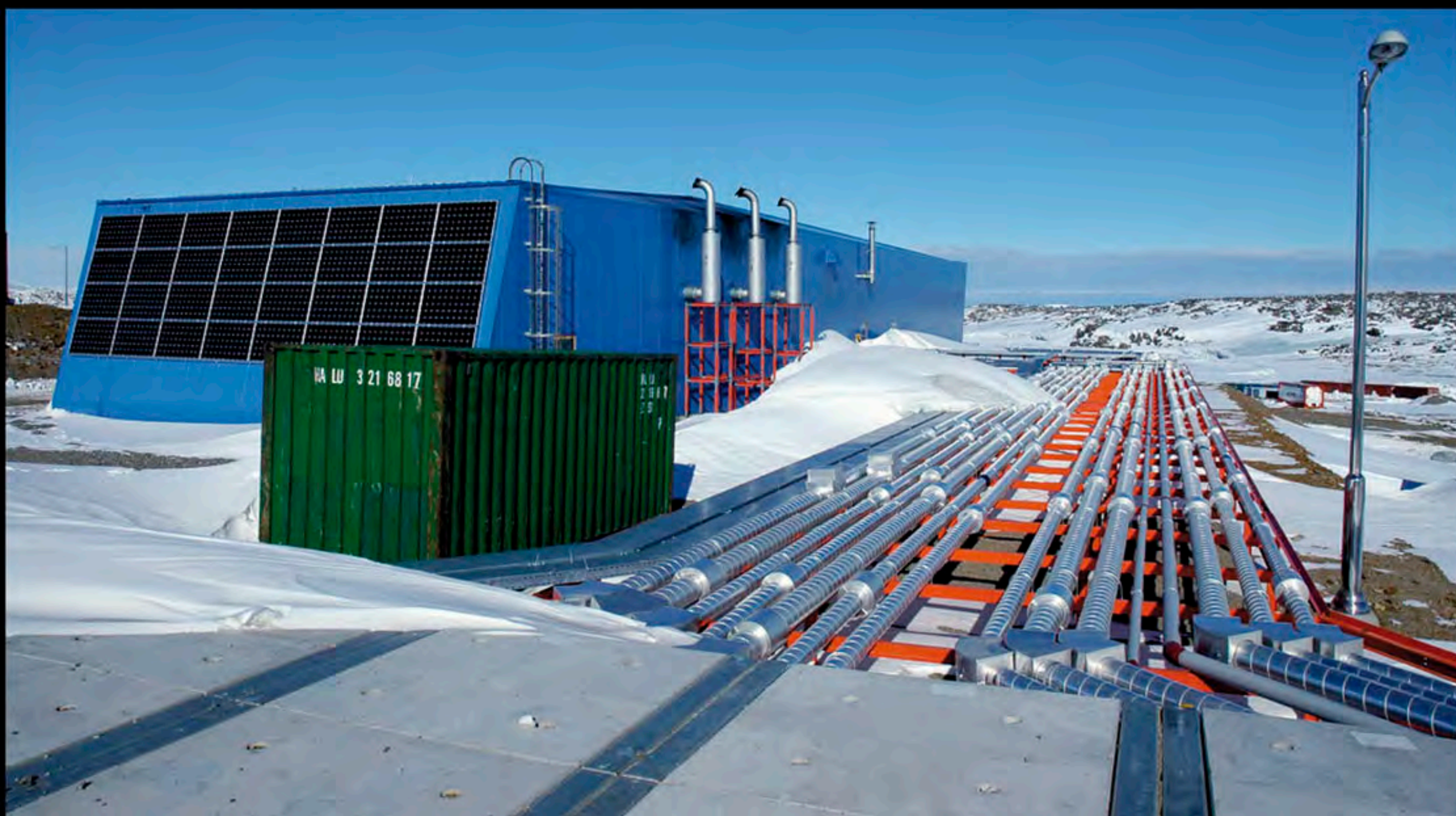
La chaufferie équipée de panneaux solaires est reliée à la base par des tuyaux chauffés
